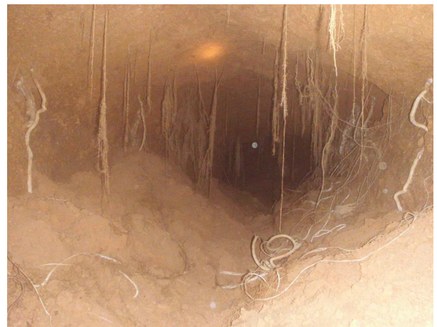
Foto 18: Tram galeria mal estat.
