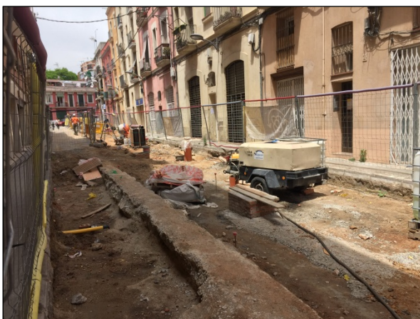
Foto 11. Rebaix del calaix extrem del tram B
