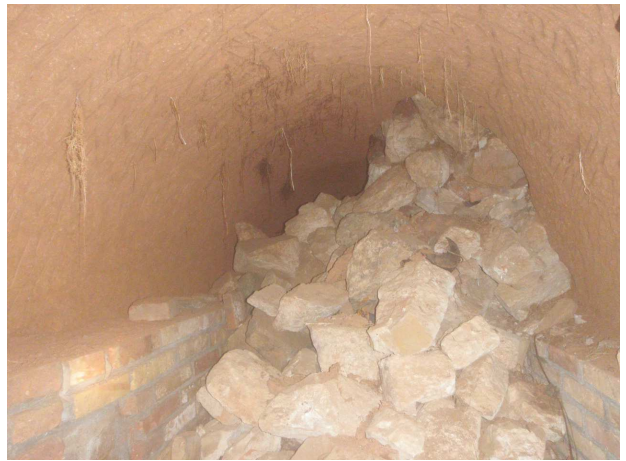
Foto 16: Tram galeria mal estat.
