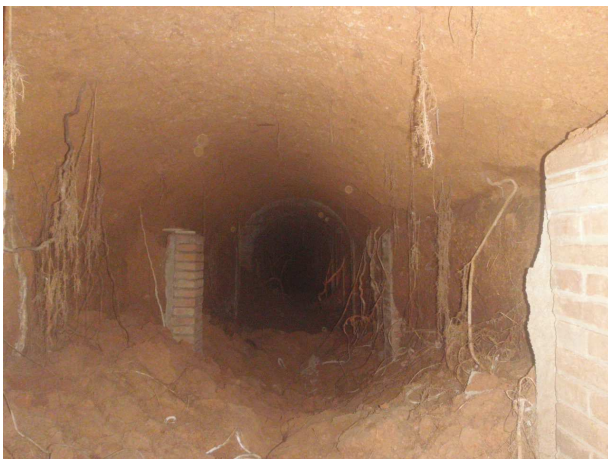
Foto 17: Tram galeria mal estat.
